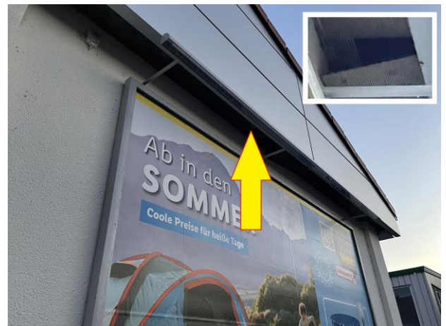
Abb. 7: Breiterer Abstand zwischen Verkleidung und Wand mit gelöster Deckenplatte.
