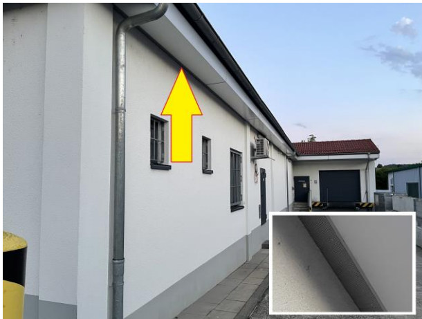
Abb. 8: Verschlüssener Spalt zwischen oberer Metallverkleidung und Wand an der Westseite.
