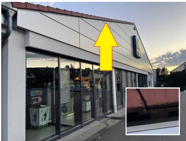
Abb. 6: Spalt zwischen glatter Metallverkleidung und Ziegel an der Nordseite des Marktes.
