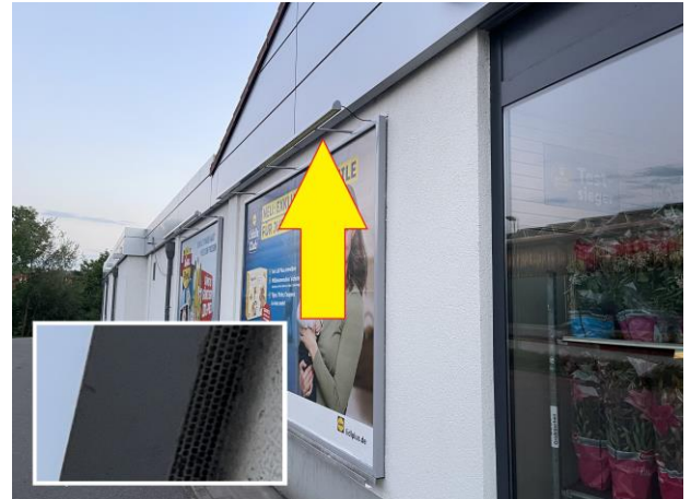
Abb. 3: Verschlossener Spalt zwischen oberer Metallverkleidung und Wand.
